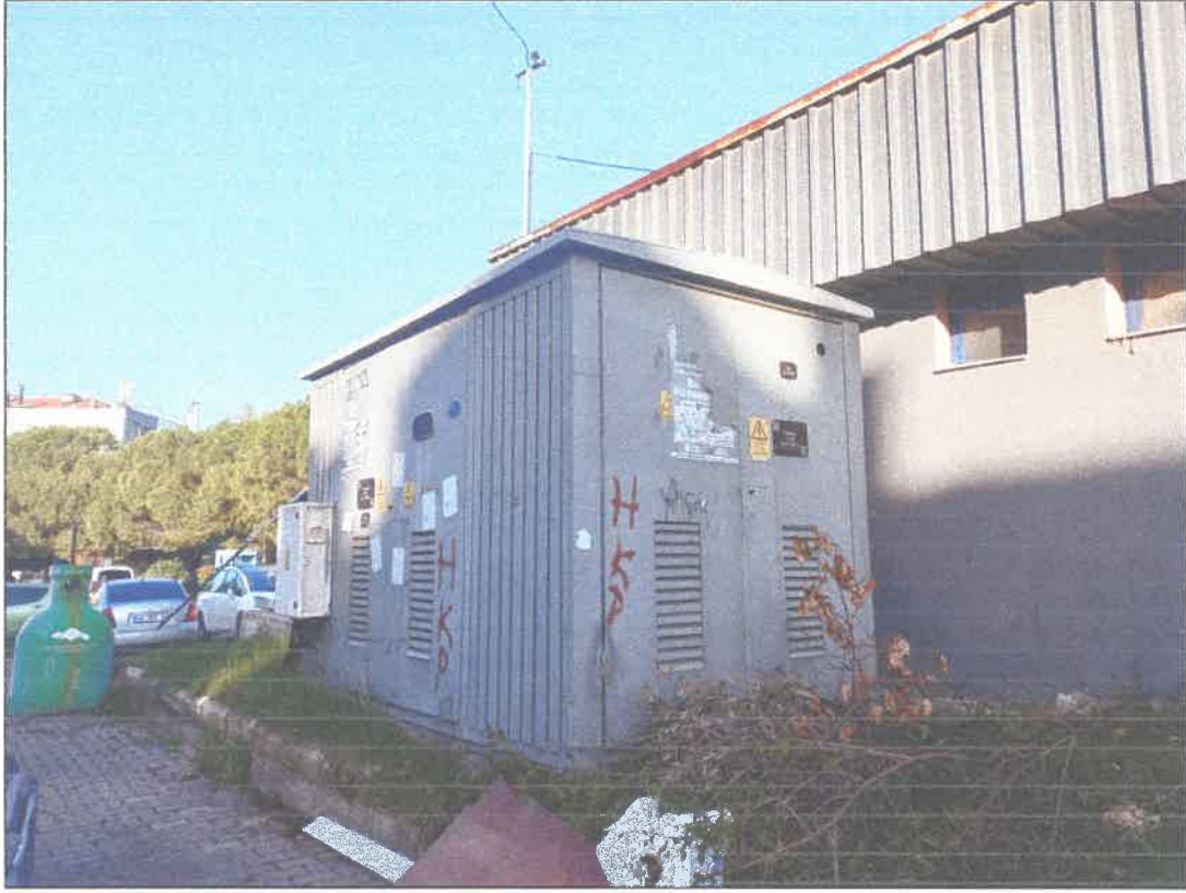
-Mevcut Trafonun Alandan Görşeli-
